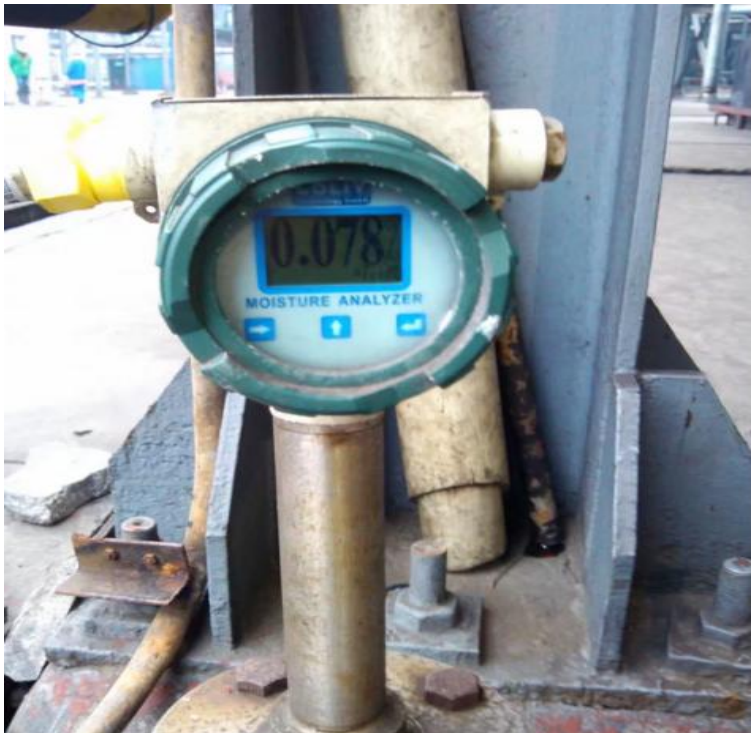
化工厂甲醇溶液水分测量
